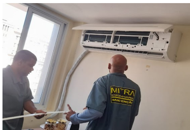
Manutenção de ar condicionado
