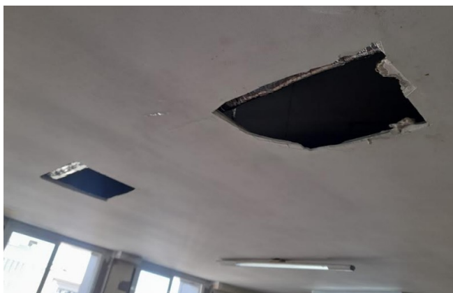
Conserto de buraco no teto do SAST
