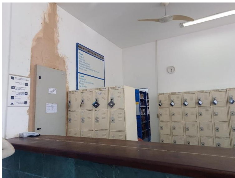
Quadro de energia no interior da recepção, na entrada da Biblioteca Central (parede restaurada pós incêndio)
