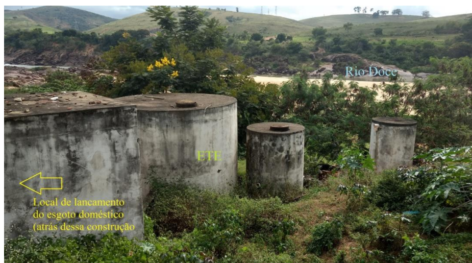
Fotografia 8 - Unidade de tratamento de esgoto inutilizada em Mascarenhas (Baixo Guandu)
