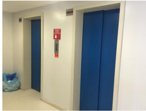
Foto 4.2.3.x. Elevador de serviço
