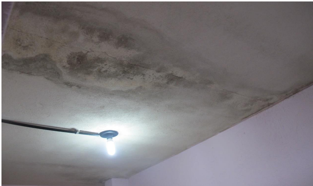
Figura 10: Infiltração na cela coletiva do Presídio Nelson Hungria. Fonte: Relatório de visita à Unidade Prisional realizado pela Defensoria Pública do estado do Rio de Janeiro
