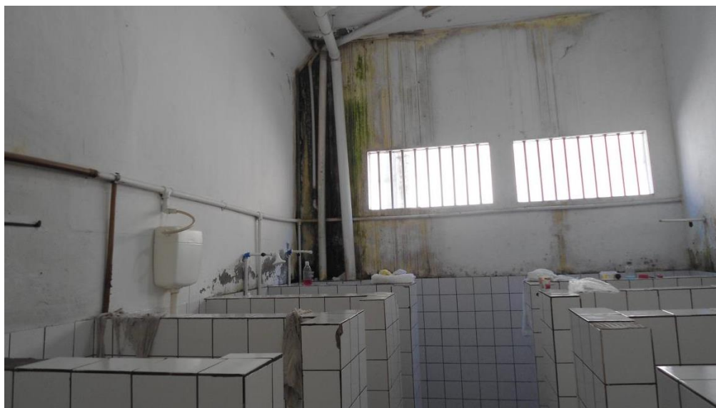
Figura 13: Infiltração em um banheiro na Cadeia Pública Joaquim Ferreira de Souza. Fonte: Relatório de visita à Cadeia Pública Joaquim Ferreira de Souza realizado pelo MEPCT/RJ
