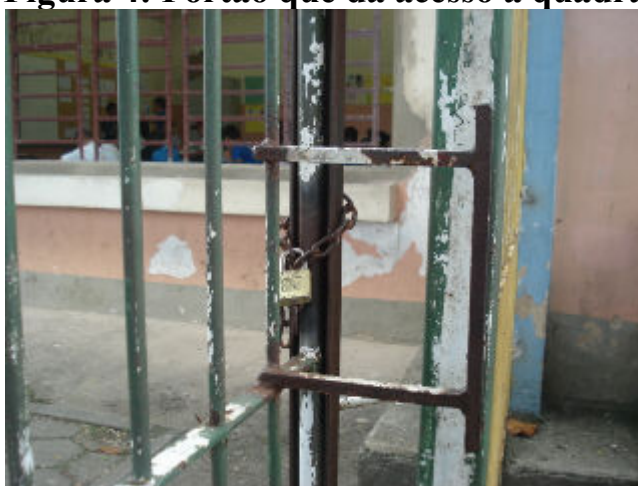
Figura 4: Portão que dá acesso à quadra
