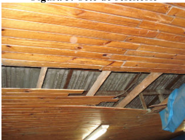
Figura 3: Teto do refeitório
