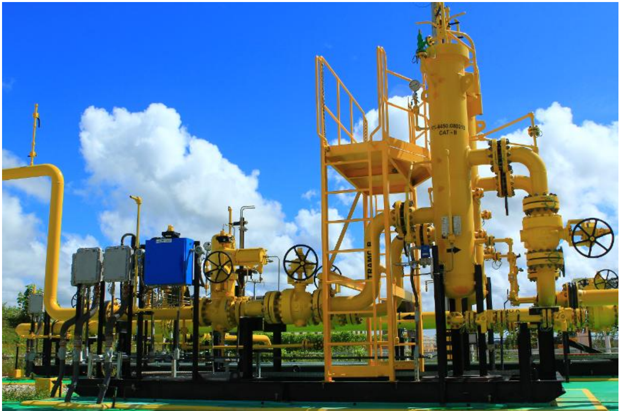
Figura 15 - Ponto de Entrega de Gás Natural operado pela Transpetro
