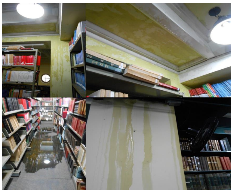
Figura 38 - Vazamentos e goteiras na CESP
