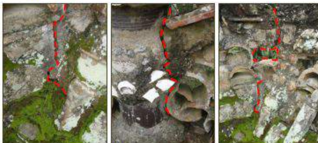
Aspectos do muro externo, apresentando pontos de desagregação. Assinalados em vermelho o caminho das rachaduras. Fotografais Joyce Kurreis Pena/2012.
