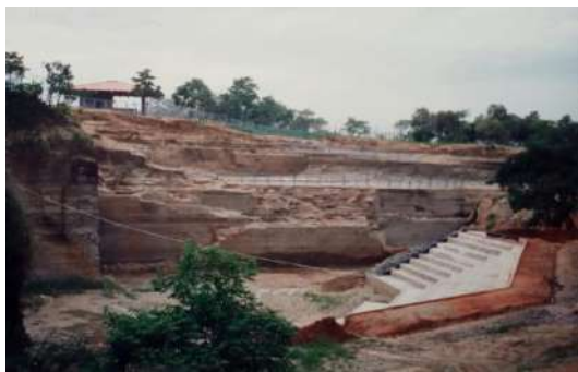
F.117 Obras de adequação da pedreira de varvito em Geoparque.1994. Projeto de Geraldo Garcia e Prof. Dr. Rocha Campos – Geologia/ USP
