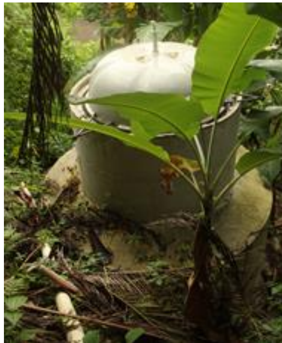
Figura 46. Biodigestor instalado abaixo da COOVE Fonte: Rioonwhatch.
