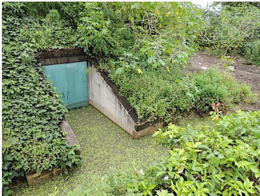
Figura 50 – Um dos paióis do Campo do Jiquiá, construído durante a Segunda Guerra Mundial, afetado por alagamentos frequentes.
