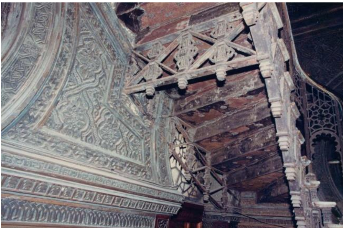
Figura 67: Condições do estuque e da escada no hall central no interior do Pavilhão Mourisco.
