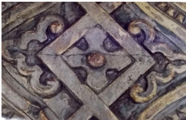
Figura A2.3: Detalhe do estado de conservação do estuque do Hall do Pavilhão Mourisco
