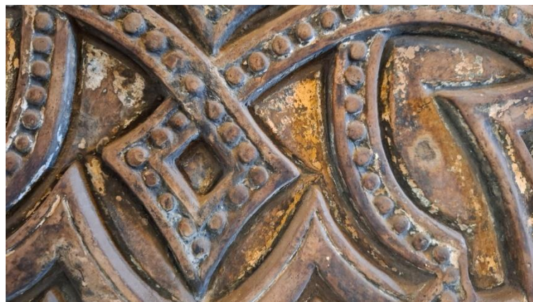
Figura 70: Estado de conservação do forro em estuque do Pavilhão Mourisco em 2024
