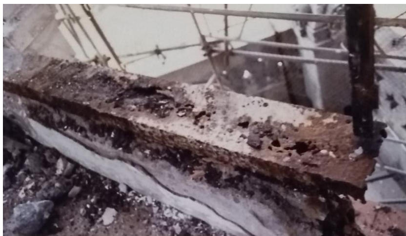
Figura A2.2: Estado de corrosão das vergas inferiores do vão da janela.
