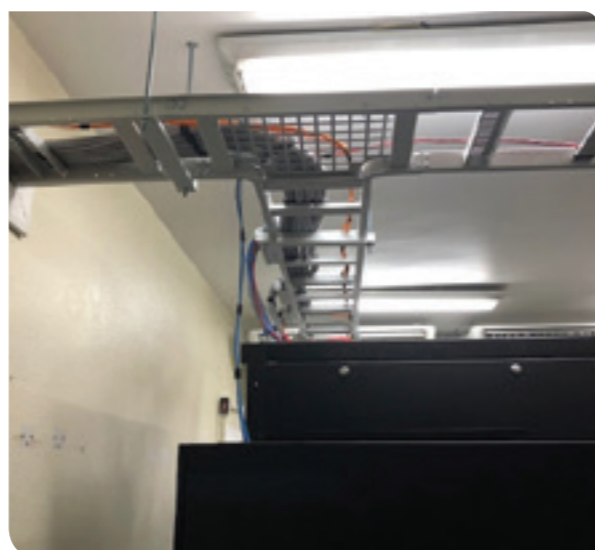
Novo Data Center da DTIC
