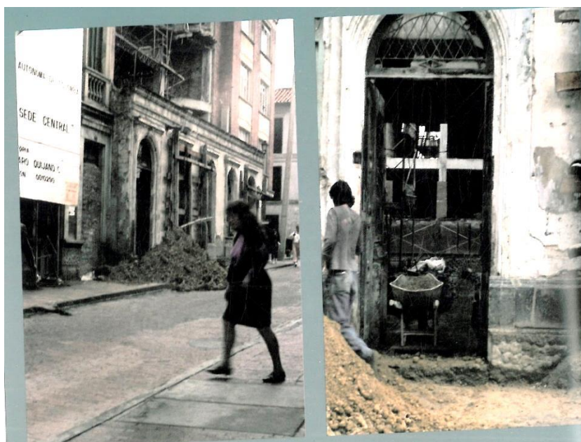
Figura 45 – Construção do novo edifício da Sede Central da FUAC (Sede XX Aniversário), nos antigos lotes ocupados pelas Casas 4 – 30 e a Casa de um andar sem nomenclatura, que faziam parte da antiga Clínica Central, 1993.
