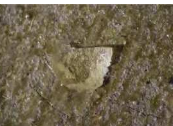
Descamação de camada de verniz.
