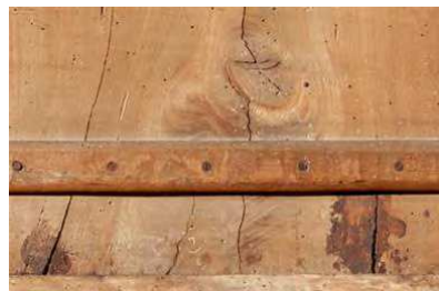
Fissura em painel de madeira.
