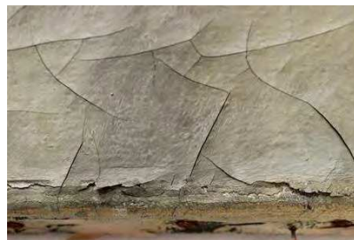
Delaminação da camada superficial e pictórica.
