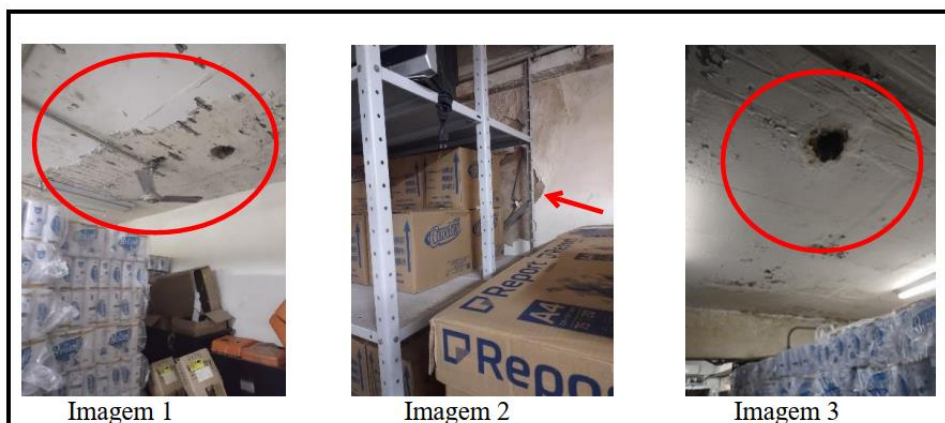
Figura 06: Estrutura aparente depreciada e com sinais de umidade.
