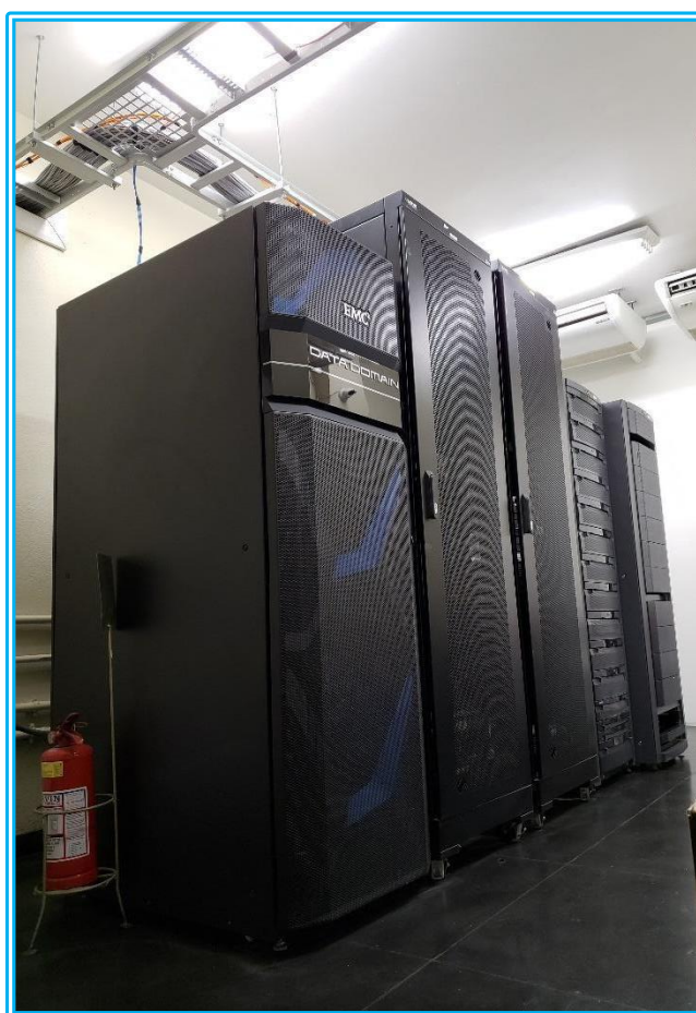
Figura 57 - Datacenter da UNIRIO
