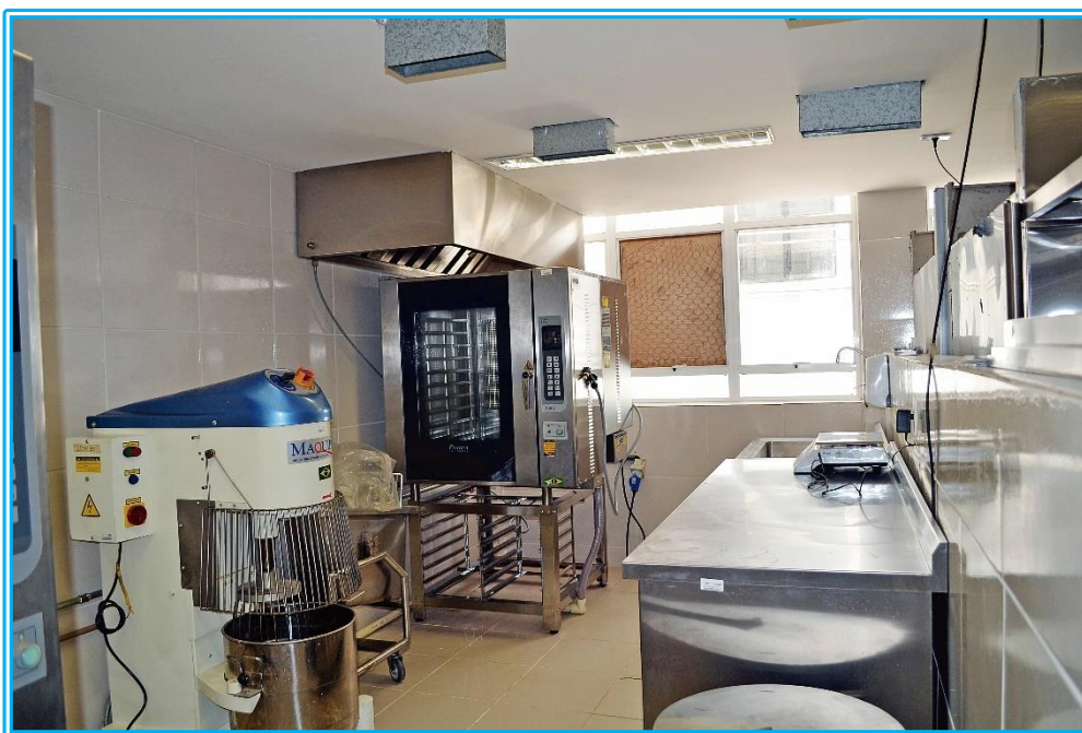
Figura 38 - Equipamentos do Restaurante Escola
