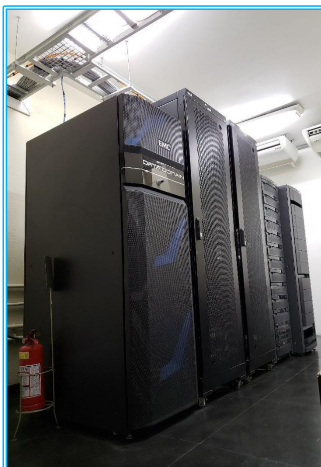
Figura 57 - Datacenter da UNIRIO
